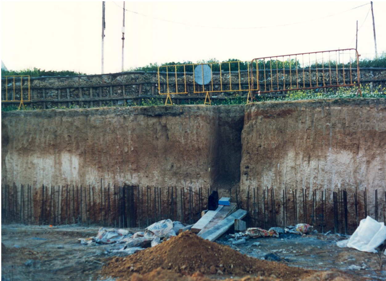
Figura 3. La Albina (La Puebla del Río, Sevilla). “Fondo de cabaña” parcialmente destruido en 1994 por unas obras municipales. Presenta la imagen típica de estas cubetas semisubterráneas interpretadas tradicionalmente como viviendas del Bronce Final.
