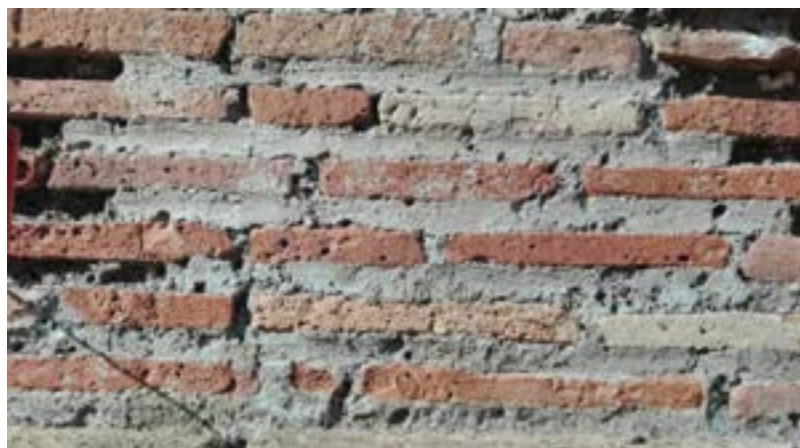
Figura 10. Dettaglio delle caratteristiche della malta (foto Ilaria Frumenti).
