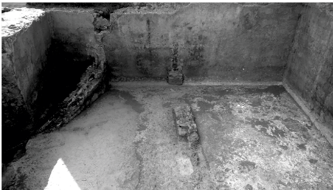
Figura 5 – Terme della Rotonda. Castellum aquae, porzione Ovest (da BUDA et al. 2015, p. 553, fig. 124).
