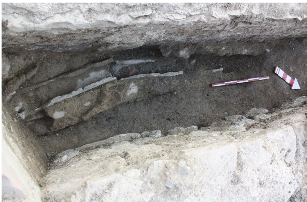
Figura 63: La canaletta di scolo delle acque SF09
