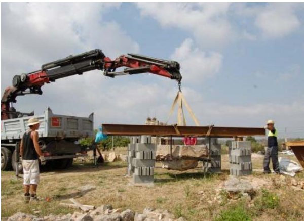
Figura II.8. Traslado de la piscina a un soporte preparado para sustentar el conjunto
