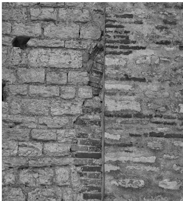
119. S. Salvatore di Valdicastro. Parete nord della navata. Stipite di finestra in laterizi, realizzata in rottura di muro, su cui si appoggia il muro risalente al 1799.
