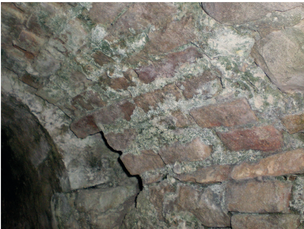
Figura. 47. Particolare dello stacco tra la muratura in mattoni e quella in pietra (P. Marino).
