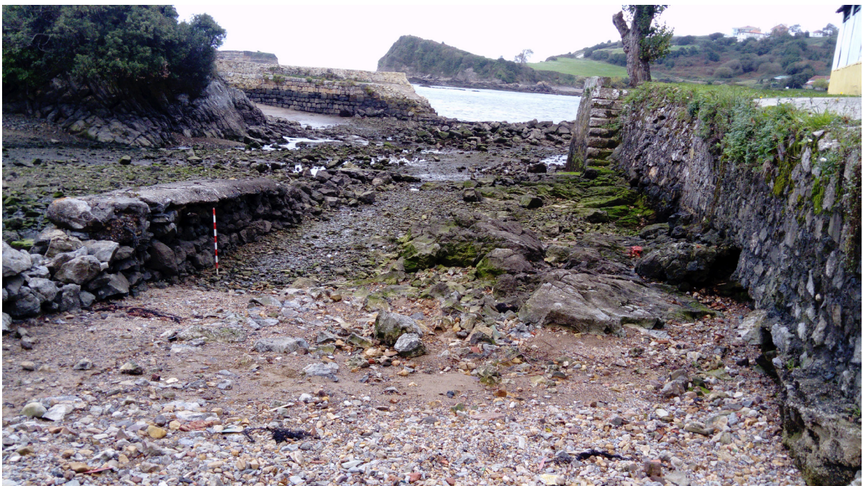
Figura 6.2.5. Vista general de los antiguos astilleros de El Dique (Luanco, Gozón) donde se observa el alto grado de alteración sobre las infraestructuras (diques, grada y muros). Al fondo, Aramar y Tierra de Moros. Foto N. Alonso Rodríguez.
