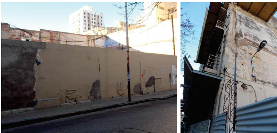
Figura 8.18. Restos de las fachadas de los Lotes 11 y 12 en donde pueden observarse las molduras utilizadas en la decoración de las mismas. Del mismo modo se observan vanos y diversas estructuras que permiten interpretar la ubicación de vidrieras de los escaparates y puertas de ingreso a los comercios y viviendas.
