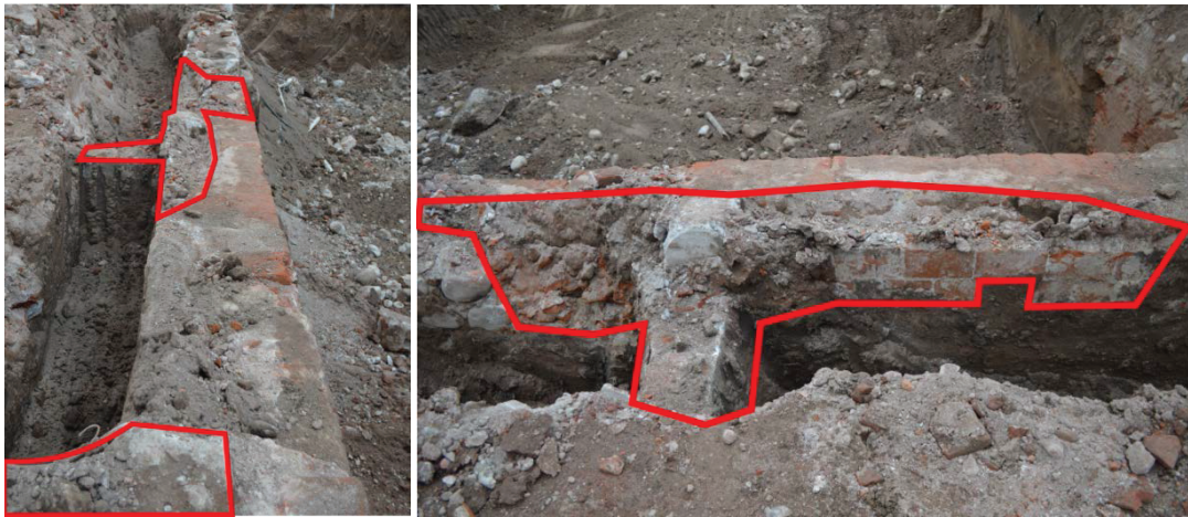
Figura 7.23. Intervenciones al muro con ingreso de material moderno (hormigón armado, cemento, ladrillos industriales) y pérdida de material antiguo Sector A. De oeste a este (desde calle Ituzaingó hacia Buenos Aires, imagen de la izquierda). De sur a norte (desde calle Entre Ríos a San Jerónimo, imagen de la derecha)
