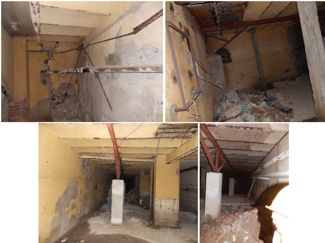
Figura 5.3. Sótano del edificio en pie del Lote 2. Se pueden observar las cañerías de hierro que conectaban los baños con el sistema de cloaca, el sistema de sostén del piso y una cantidad de escombros de una demolición previa que ocupaba parcialmente el espacio. En la foto superior derecha se puede ver la base del cimiento que contiene ladrillo y piedra bola. Reutilización de material que se observó recurrentemente durante la excavación.
