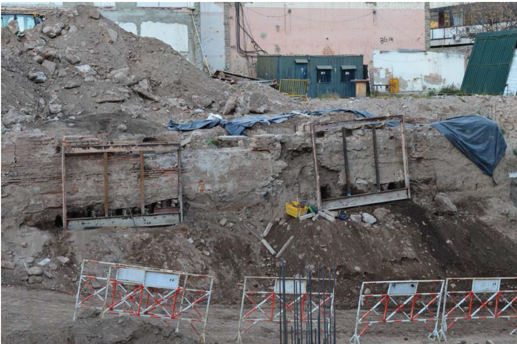
Figura 12.15. Los dos sectores del muro con sus armazones finalizados y listos para su confinamiento final y remoción.
