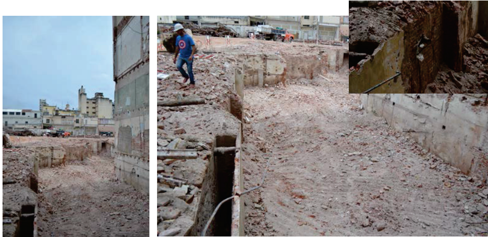
Figura 5.16. Izquierda: Vista general del Lote 2 luego de la excavación sistemática y de la demolición de las estructuras. Derecha: Detalle de doble pared del sótano y detalle donde se pueden apreciar los caños de hierro descriptos anteriormente (UE14 y 17).
