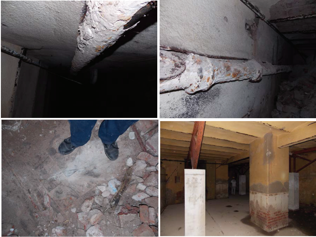
Figura 5.2. Sótano del edificio en pie del Lote 2. Se pueden observar las cañerías de hierro que conectaban los baños con el sistema de cloaca, el sistema de sostén del piso y una cantidad de escombros de una demolición previa que ocupaba parcialmente el espacio.
