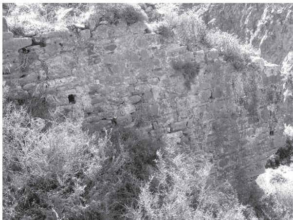
Figura 116. Particolare della tecnica edilizia impiegata nelle strutture del ponte sifone pertinenti l'epoca protobizantina.
