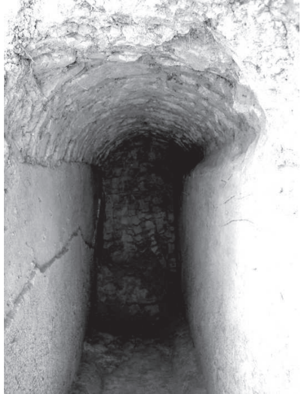
Figura 78. Interno del condotto con le tracce di calcare lasciate dall'acqua sul rivestimento delle pareti.
