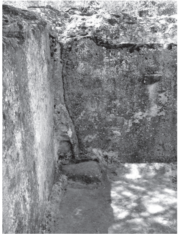
Figura 169. Interno della vasca; dettaglio della parete meridionale con le pedarole per la discesa e il foro per lo svuotamento della vasca nelle operazioni di pulizia e manutenzione.
