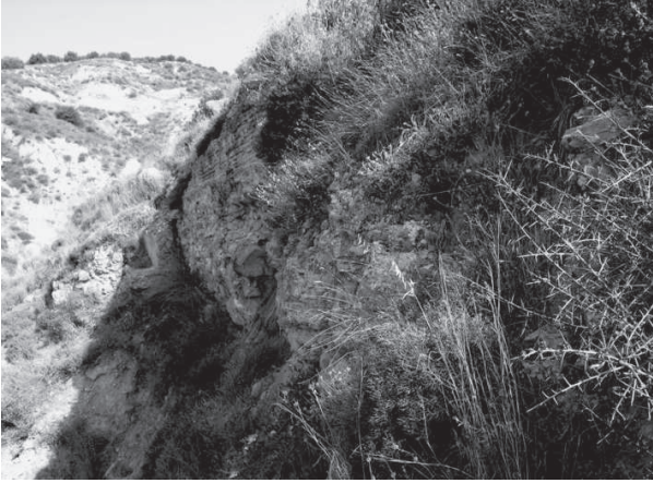
Figura 117. In primo piano traccia della frana che ha danneggiato l'acquedotto, sullo sfondo la struttura rivestita con la cortina laterizia e, più a valle, lo speco, poi obliterato.
