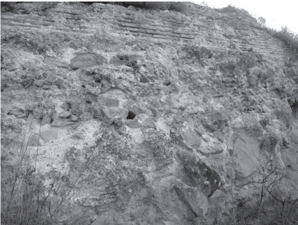
Figura 119. Un tratto della struttura in cui è ben conservata la cortina laterizia di rivestimento.
