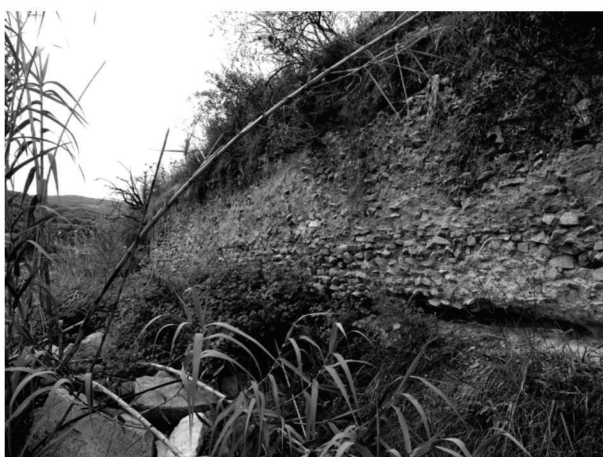
Figura 95. Tratto dell'acquedotto privo del rivestimento con il nucleo della muratura in cementizio a vista.
