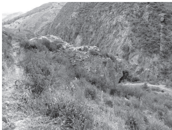
Figura 115. Vista da NW del ponte sifone. In primo piano la muratura della spalla occidentale del ponte che foderà le strutture preesistenti e la nuova vasca di raccolta in età protobizantina; sulla destra dell'immagine la spalla orientale del ponte che presenta uno spessore sensibilmente inferiore.
