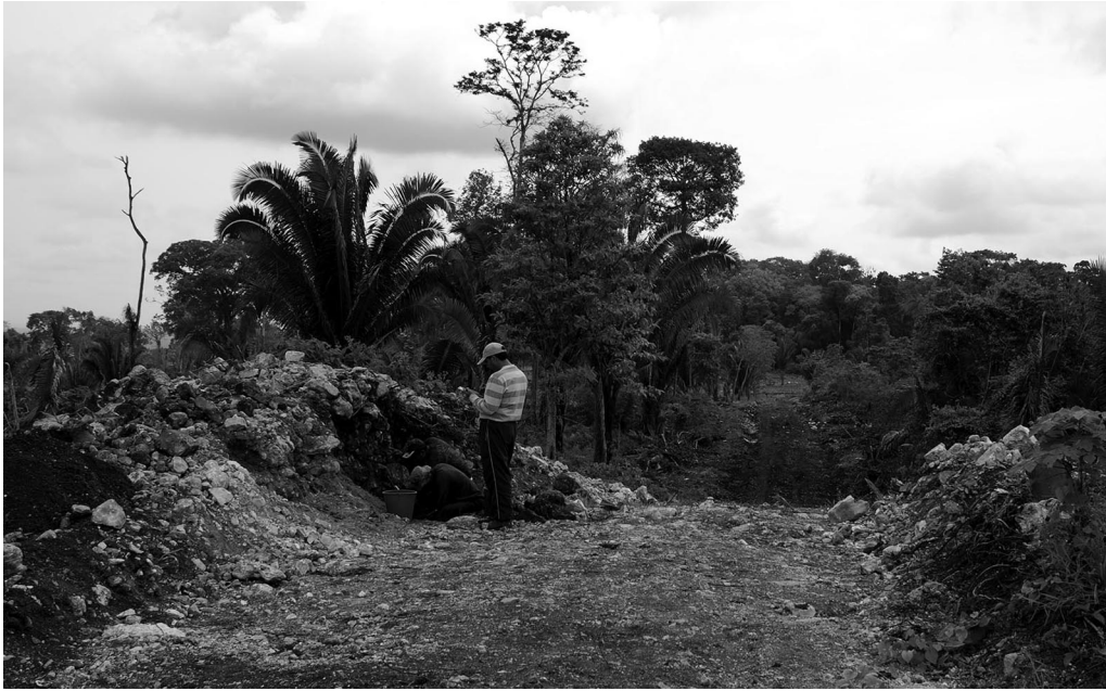
Figura 3.53. Limpieza de la Estructura 5SS-4 en el Grupo 5SS-b, dañada por la construcción de una calle a lo largo de la brecha del Monumento Cultural Dos Pilas (fotografía de M. Eberl).
