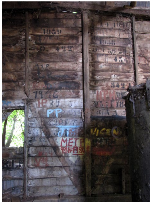
FIG. 91 INSCRIPCIONES EN LAS PAREDES DE MADERAS DE LAS ESTRUCTURAS DE LA COMPAÑÍA QUE SE DERRUMBAN SOLAS CON SU EQUIPAMIENTO EN EL INTERIOR; CADA MADERA ESTÁ FECHADA.
