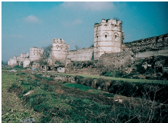
3. Constantinopolis (Törökország) falai. 1453-ban került török fennhatóság alá. Ez a Római Birodalom végét jelentette. 3. The walls of Constantinople (Turkey). It was in 1453 that they fell to the Turks and the Roman empire came to an end
